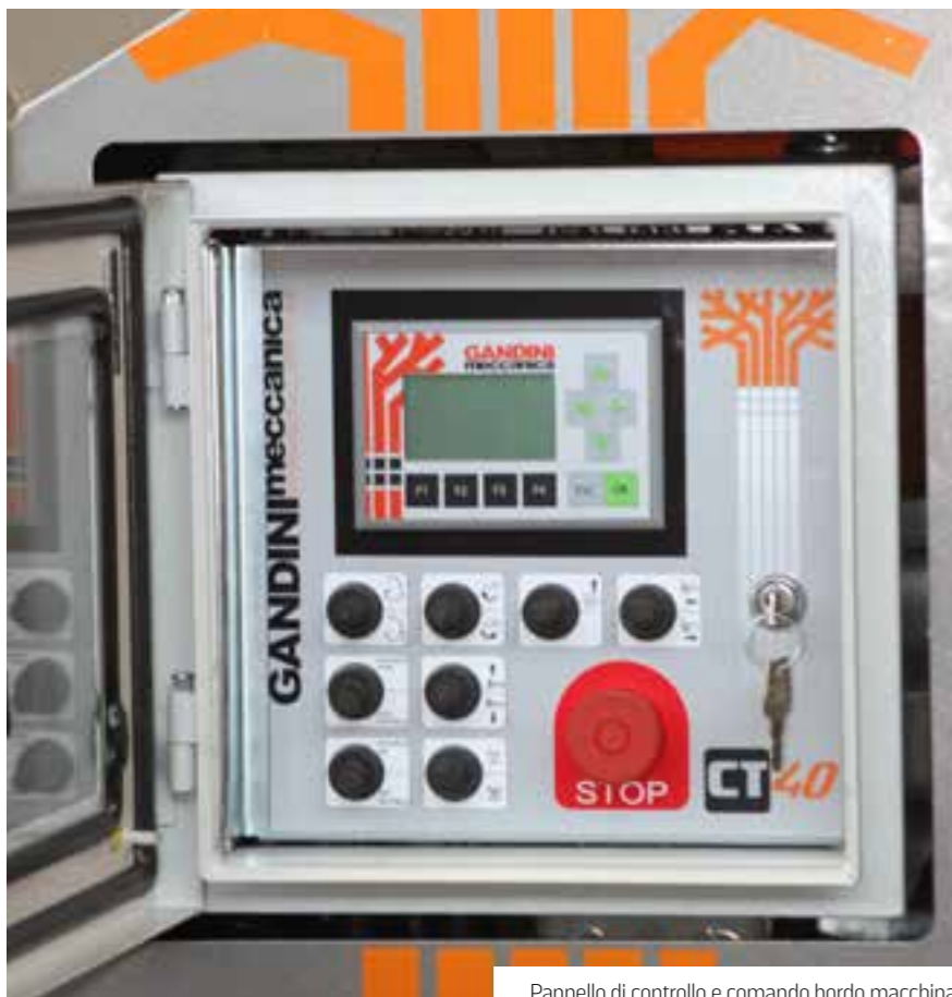
Pannello di controllo e comando bordo macchina
