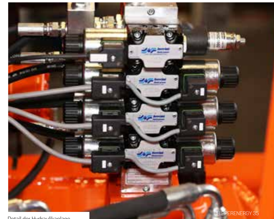
Detail der Hydraulikanlage
